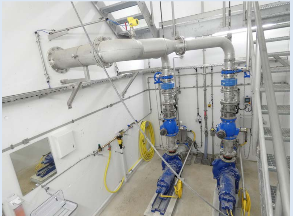
Trocken aufgestellte Pumpen im neu errichtetem Schmutzwasserpumpwerk Splieterstraße
